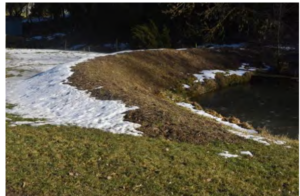
Ein vom Grundeigentümer im Winter 2018/19 errichteter Behelfsdamm markiert die optimale Stelle für die Dammanlage am oberen Teich.
