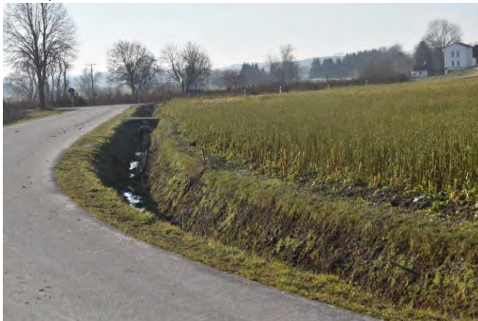
Straßengraben mit minimalem Gefälle und wenig Platz, Aufnahme 2019
