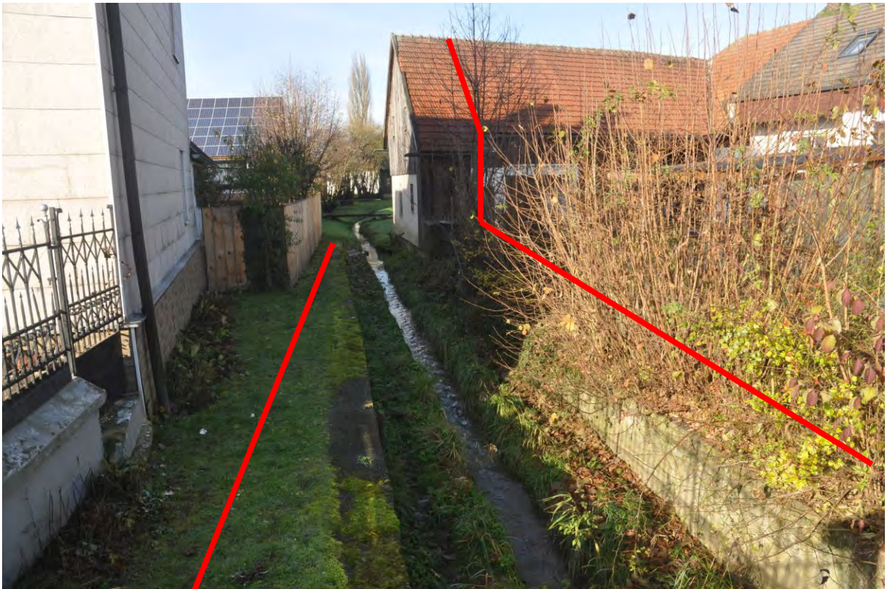
Flächennutzung Adlhausen, der verstaute Helchenbach: Die Grenzen des kommunalen Grundstücks nach digitaler Flurkarte sind grob als rote Linien dargestellt. Während die Anrainer links im Bild noch einen gewissen Sicherheitsabstand zum Bach einhalten, hat der Anwohner rechts das kommunale Grundstück nennenswert überbaut, dadurch Rückhalteraum verringert und zugleich überflutungssensible Flächen geschaffen.
