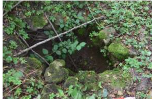
Beschädigter Notüberlauf am oberen Rückhaltebecken: ein Hohlraum hat sich gebildet, die Pflasterung ist verschwunden. Die Gefahr eines Deichbruchs ist erhöht.
