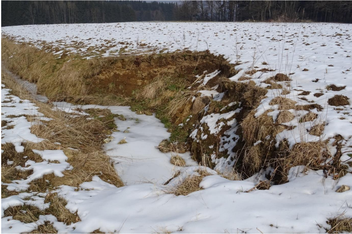
Bild 1: Uferabbruch am Ende der Verrohrung
